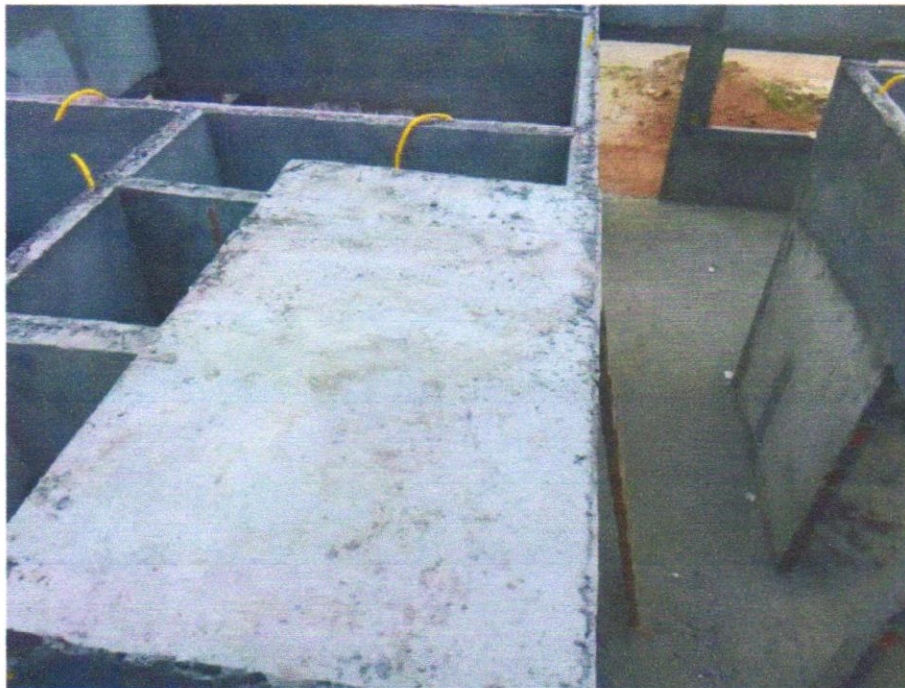
FOTO 01 – (COMPOSIÇÃO REPRESENTATIVA) EXECUÇÃO DE ESTRUTURAS DE CONCRETO ARMADO, PARA EDIFICAÇÃO HABITACIONAL UNIFAMILIAR TÉRREA (CASA EM EMPREENDIMENTOS), FCK = 25 MPA. AF_01/2017
